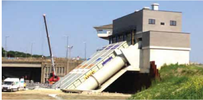
Exemple d'équipement de production hydroélectrique en cours d'installation sur certaines écluses du canal Albert
